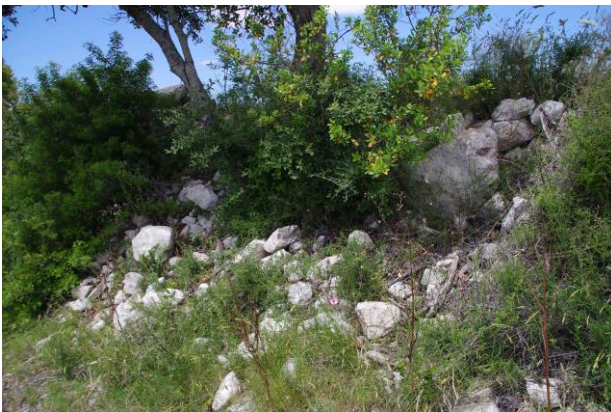
Tram 3, deficiències en les parets seques
