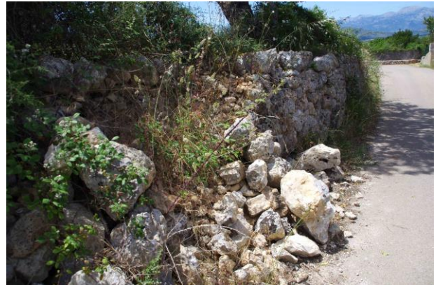
Tram 5, mur deteriorat en el seu pas pel Molí de Can Corbera
